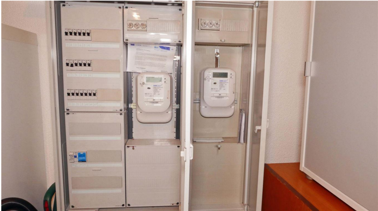
separate Strominstallation mit eigenem Zähler
