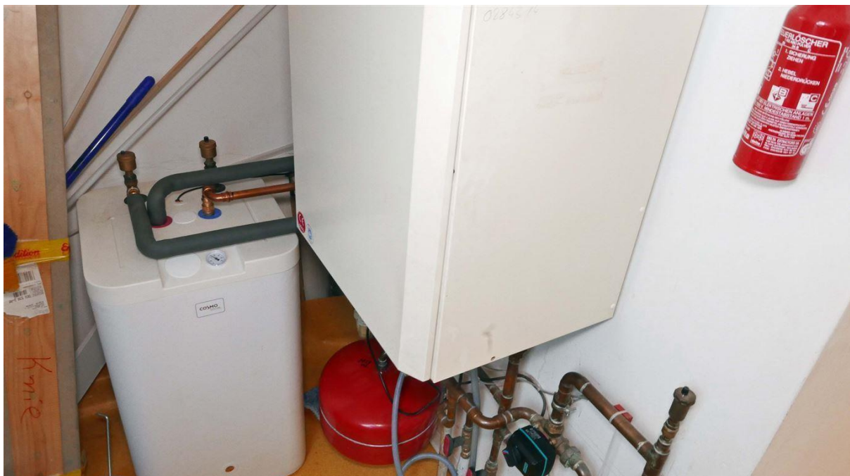
eigene Erdgas-Heizung, Baujahr 1997 mit Warmwasser
